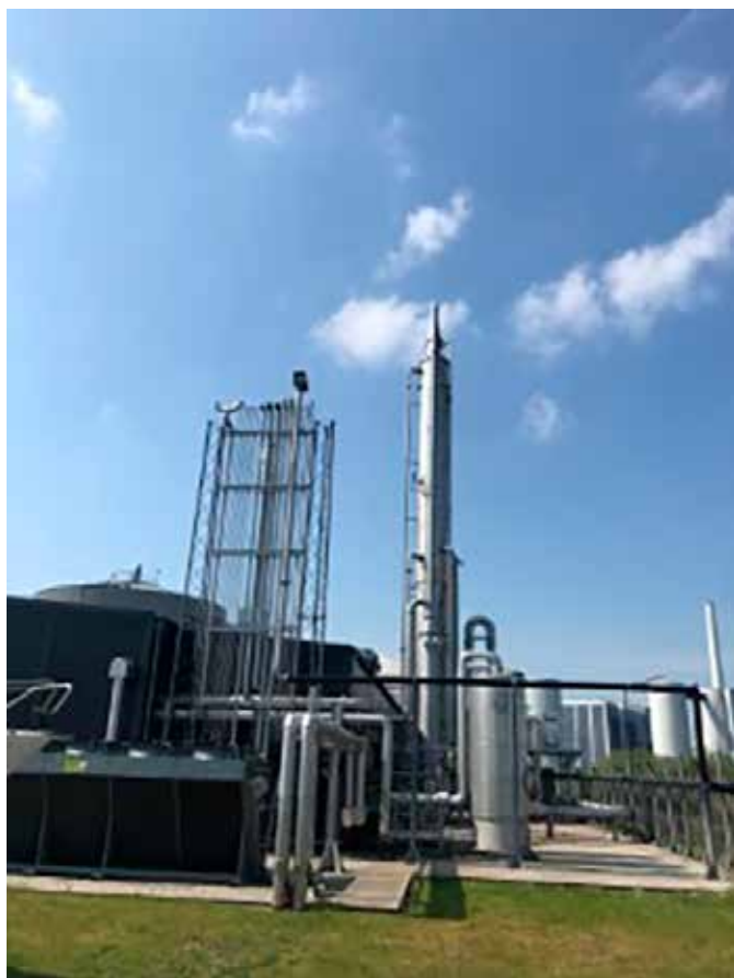
Biogasanlæg. Biogas indeholder typisk 60-65 % metan ( \text{CH}_4 ) og 35-40 % kuldioxid ( \text{CO}_2 ). Før biogassen tilsluttes gasnettet renses den for \text{CO}_2 på biogasanlægget. Den fangede \text{CO}_2 udledes lige nu til atmosfæren (kilde: Henrik Sulsbrück).
