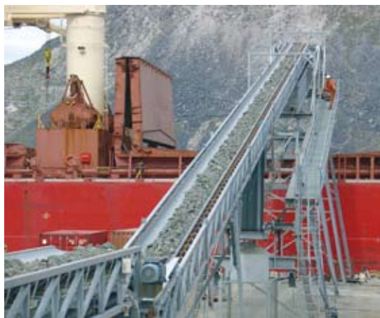
På kajen i Nalunaq er der transportbånd, hvorfra malmen lastes direkte over i malmskibet.
