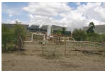
Øverst: 2 x 3 Køletårne ved Olkaria geotermisk kraftværk.
