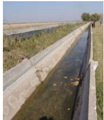
Vandingskanaler bestående af betonrør kilometer efter kilometer.
